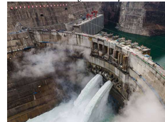
une centrale hydraulique (b)
